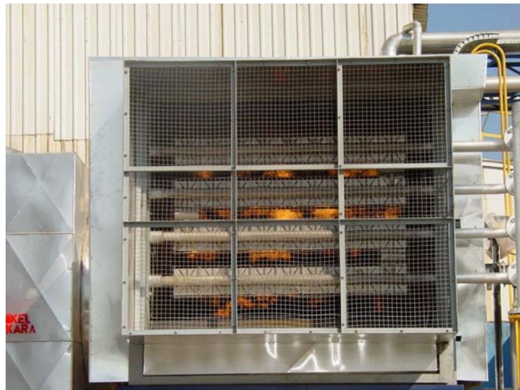
Flue Fire Brülörü Yanarken
